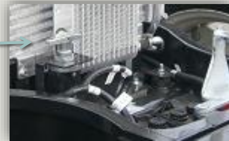
Batterie mit Hauptschalter
